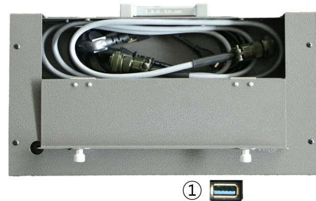
신호기 Control Box(정면)
